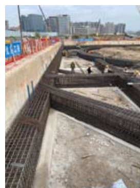
■ 深圳市前海交通樞紐地下6層立 牆面防水工程，重點部位採用 BESTONE混凝土灌注
